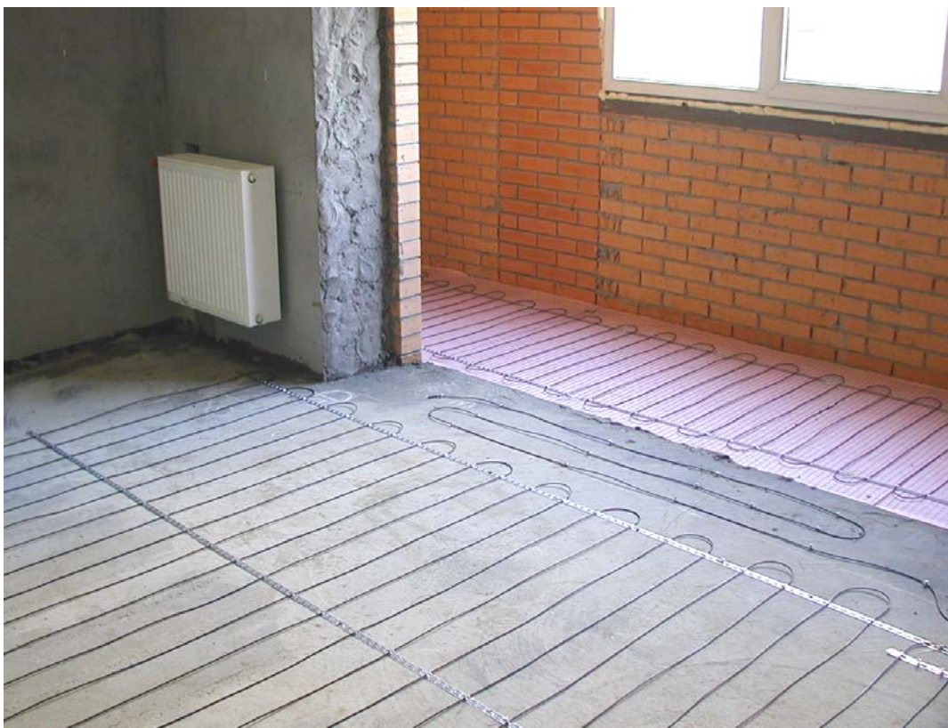
Рис. 8. На кухне кабель уложен на не утепленное основание. Пол лоджии утеплен экструдированным полистиролом. Пол кухни и пол лоджии обогреваются отдельными комплектами кабеля.
